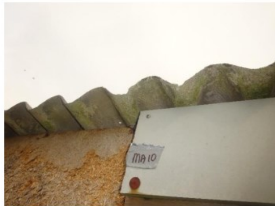
Monsternamelocatie MA10 (asbest aantoonbaar)
