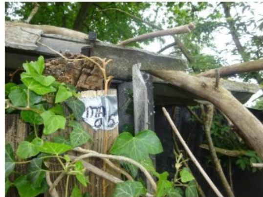
Monsternamelocatie MA05 (asbest aantoonbaar)
