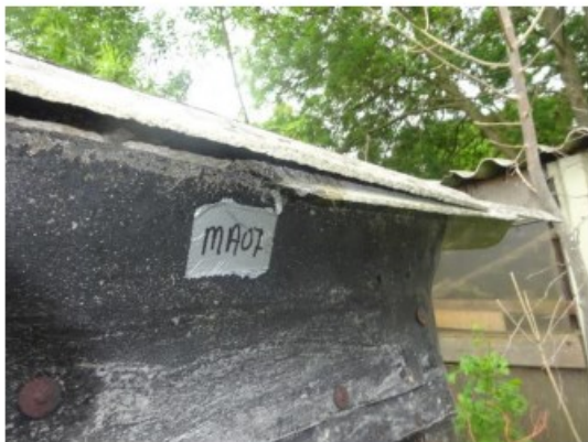
Monsternamelocatie MA07 (asbest aantoonbaar)
