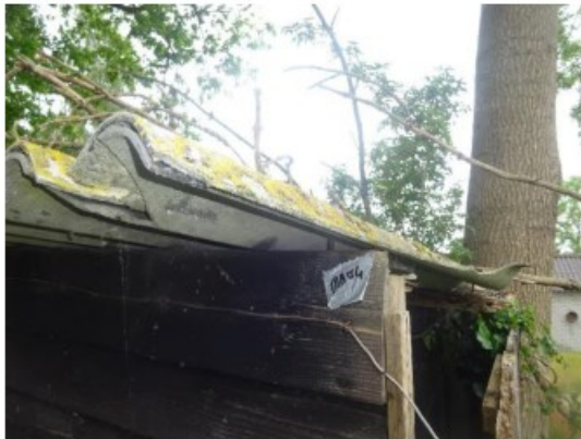
Monsternamelocatie MA04 (asbest aantoonbaar)
