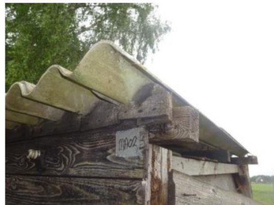
Monsternamelocatie MA02 (asbest aantoonbaar)
