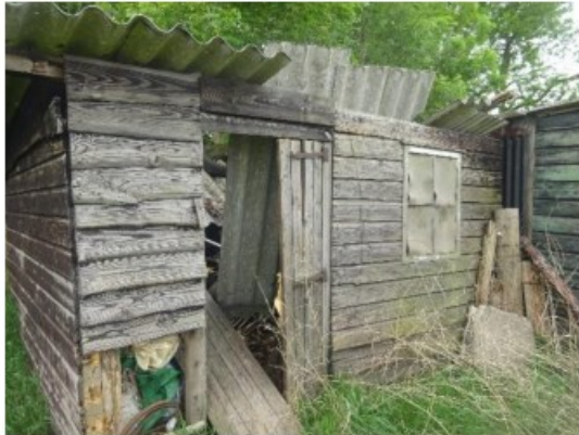
Gedeelte van het dak is ingestort
