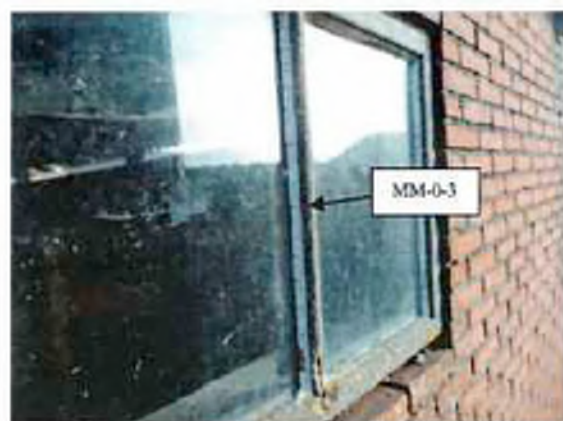
Foto 7: Asbesthoudende stopverf in betonnen raamkozijnen van schuur 2.
