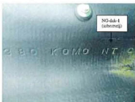
Foto 4: NT-code waargenomen in asbestvrije golfplaat als gedeeltelijke dakbedekking van schuur 1.
