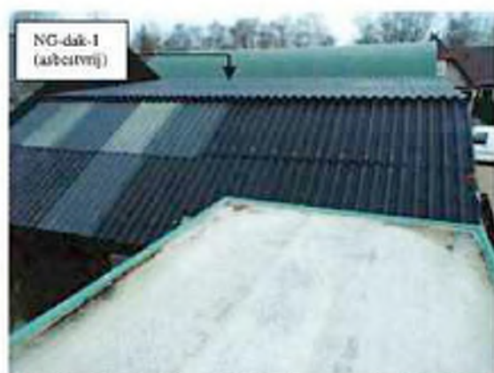
Foto 3: Asbestvrije golfplaat als gedeeltelijke dakbedekking van schuur 1. (NT-code waargenomen)
