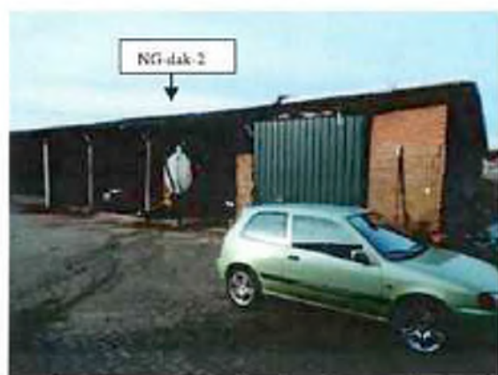
Foto 9: Geinventariseerde schuur 3 met asbesthoudende golfplaten als dakbedekking vanuit noordwestelijke richting gezien.
