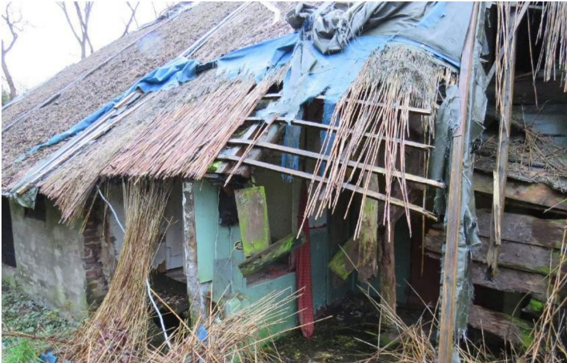
Flinke schade aan de linker zijgevel.
