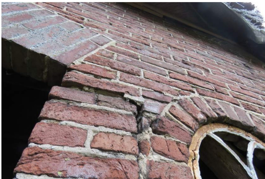
Ontzet metselwerk en verweerd en uitgevallen voegwerk.
