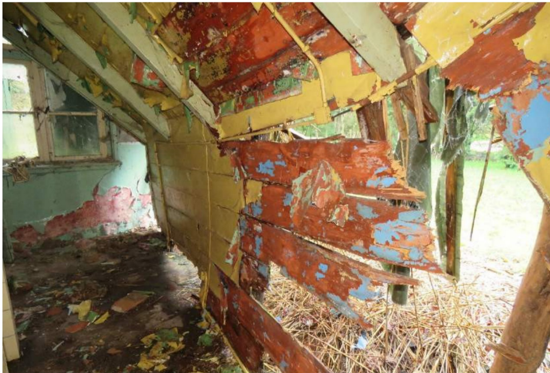
Grote schade door (deels) ingestorte linker zijgevel.
