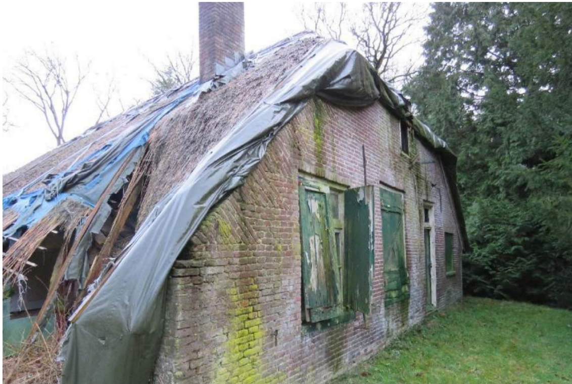
Afbladderend schilderwerk, houtrot en groene aanslag op de gevels.
