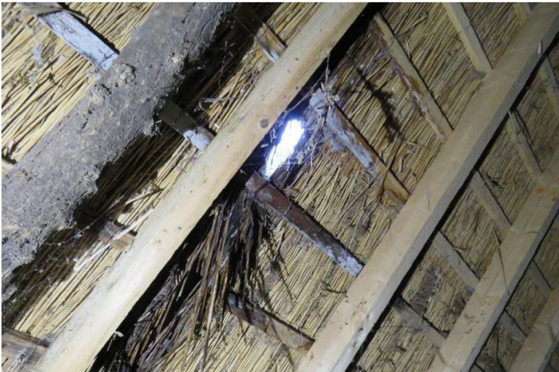
Dunne rietbedekking veroorzaakt diverse lekkages.
