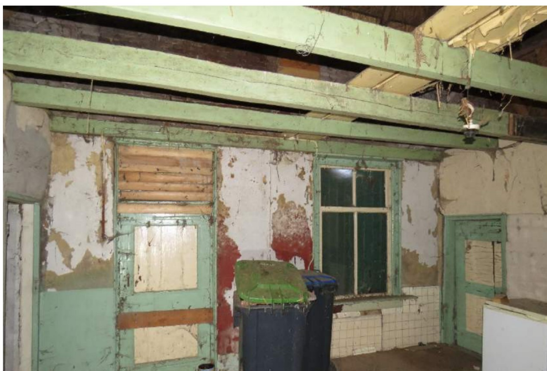
Zicht op het voorhuis. De zoldervloer is niet meer aanwezig.
